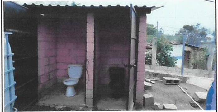
Ampliación y mejoramiento de servicio sanitario, cambio de loza en los dos baños
